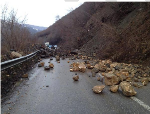
Foto 5 - Rrëshqitja e dheut në rrugën nacionale N2, lokacioni: Kulla e Çeshmes (foto: draft-PZHK 2023-2031)
