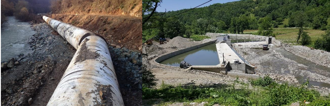
Foto 9 - Shkatërrimet mjedisore nga Hidrocentrali "Lepenci 3" – gypi i shtrirë për 10km dhe vepra e marrjes
